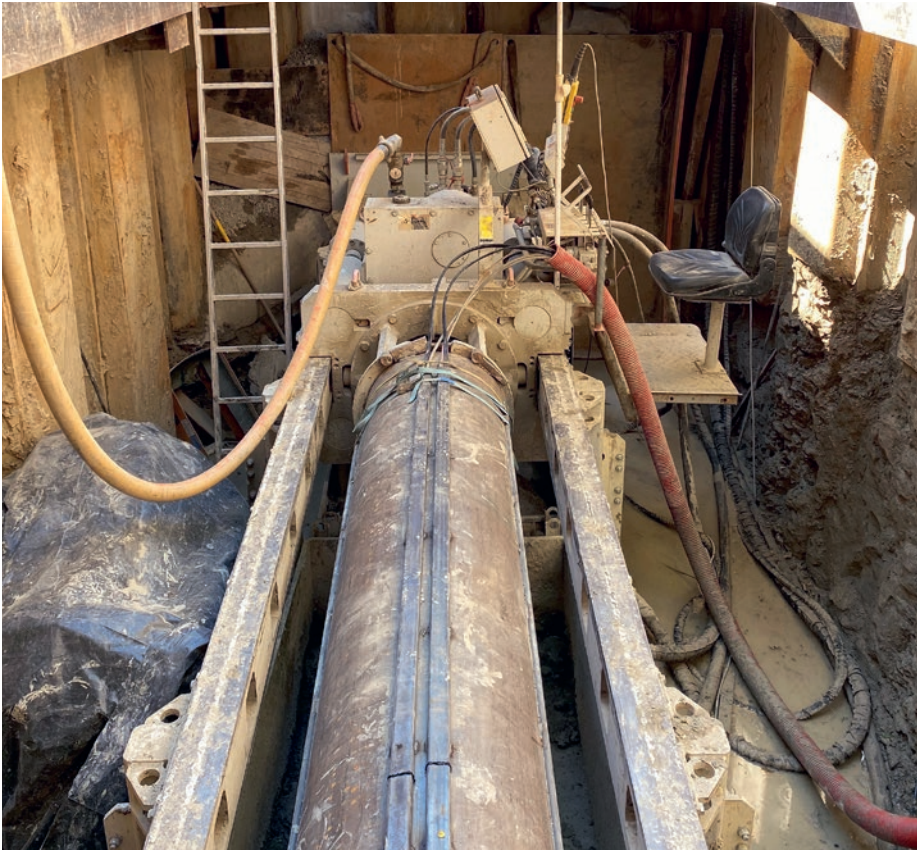
Bohranlage mit eingelegtem Bohrrohr sowie den Schutzblechen für die Steuer- und Messkabel.
